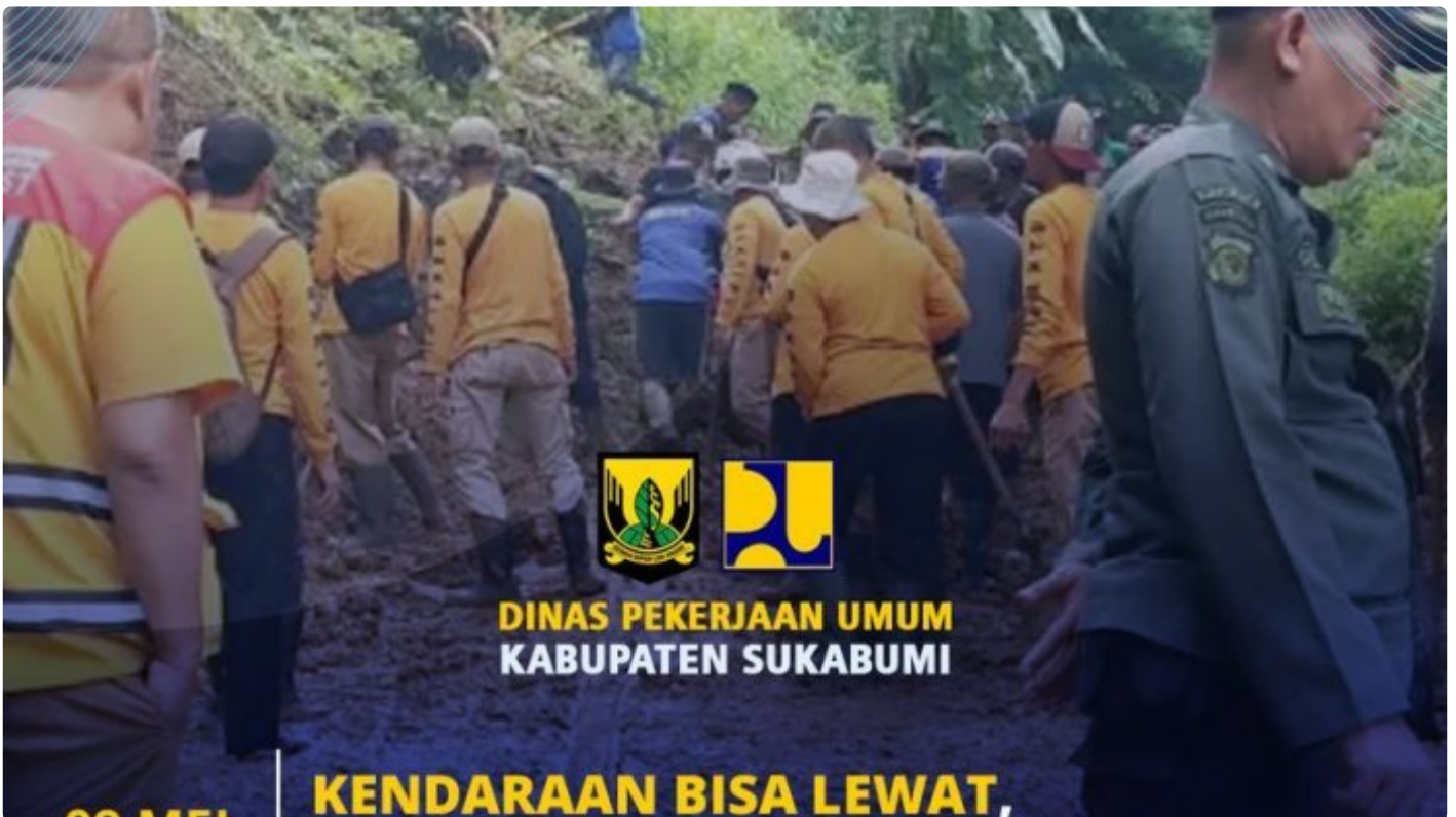
UPTD PU Sagaranten Sukabumi Evakuasi Material Longsor yang di Ruas Jalan Cimanggu-Cicukang
