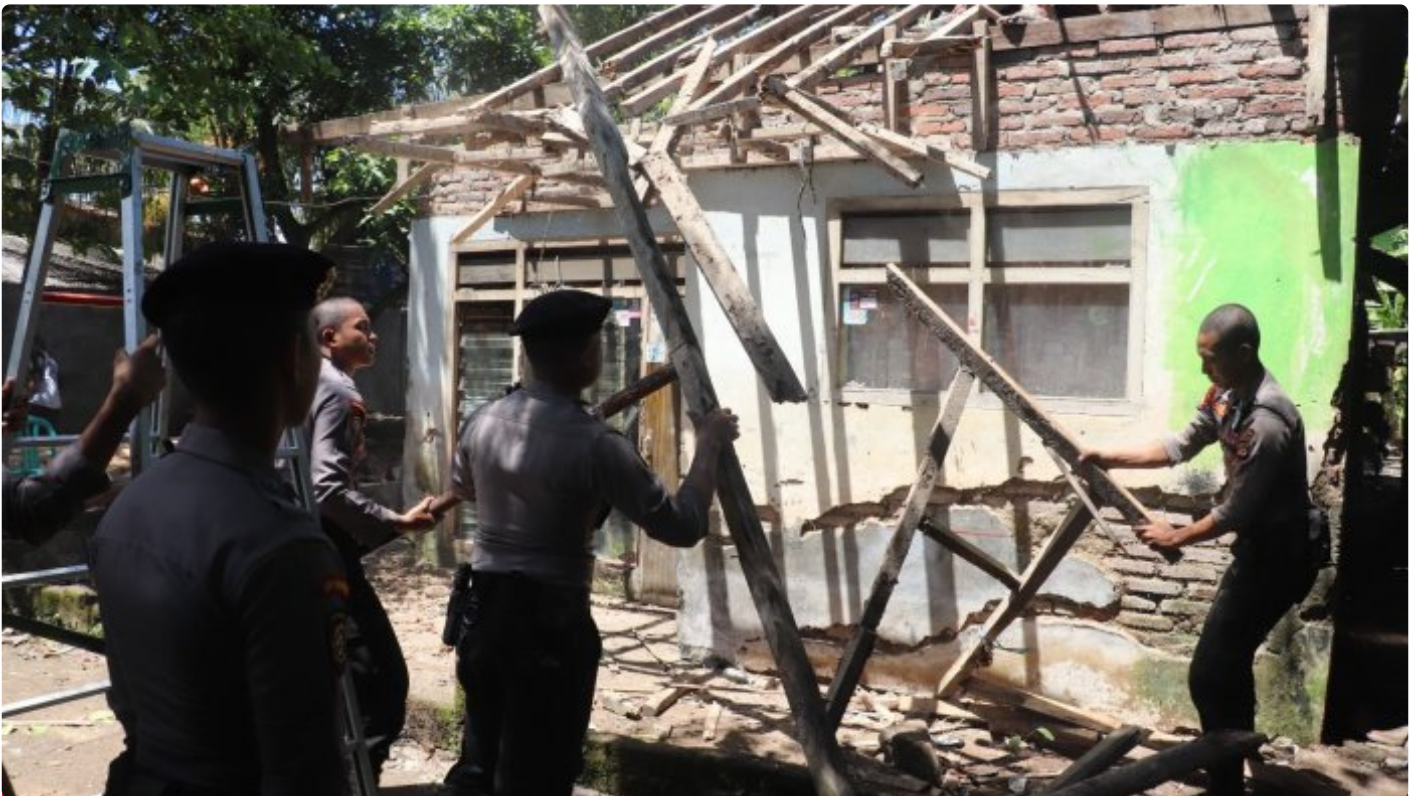
Satu Rumah lagi Diruntuhkan Aa Dede, Karena Tidak Layak Huni di Simpenan Sukabumi untuk Direhab
